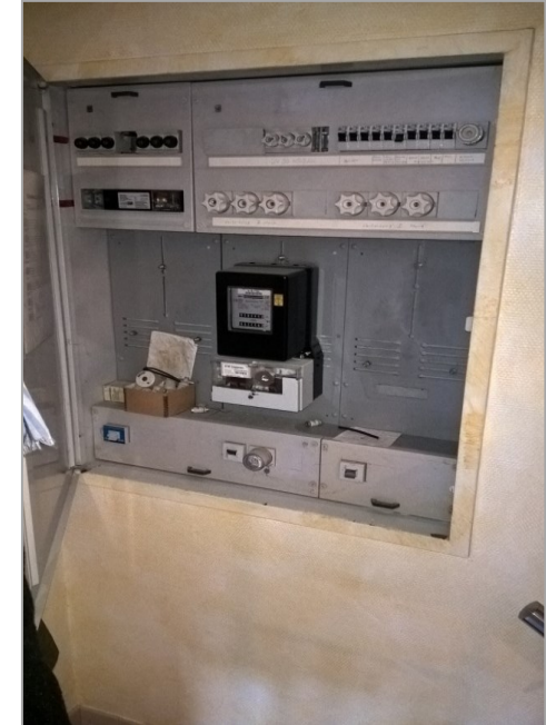
© Veith Gebäudetechnik GmbH & Co. KG
