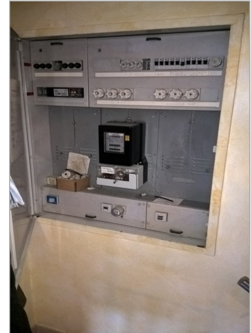
© Veith Gebäudetechnik GmbH & Co. KG
